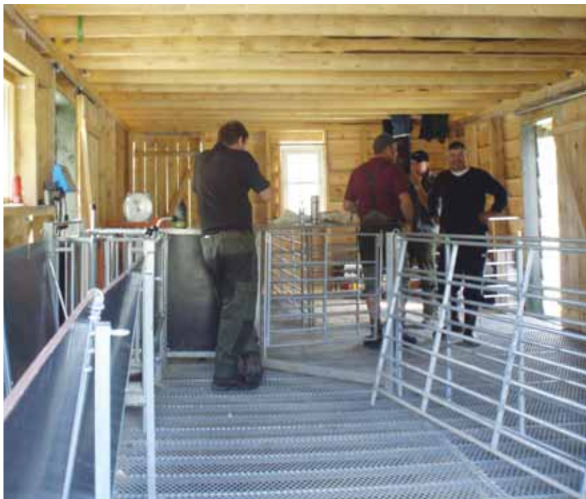
Hjartet av sorteringsanlegget der sjølv sorteringa føregår. Dette er noko av dei mest funksjonelle anlegga ein kan tenkje seg.
