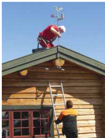
Montering av verstasjon på sætra til forsøksvert Håkon Gjølstad i Øystre Slidre.
