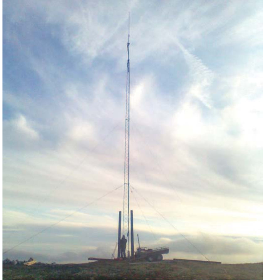
RAGER HØYT: Den nye VHF-radiomasta på Rogne i Ålen er 17 meter høy og står så høyt at den, sammen med den gamle masta i Haltdalen, gir radiodekning i hele Holtålen kommune. (Foto: Stig H. Morken)
